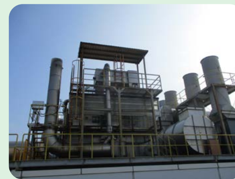
揮發性有機物廢氣處理設施
